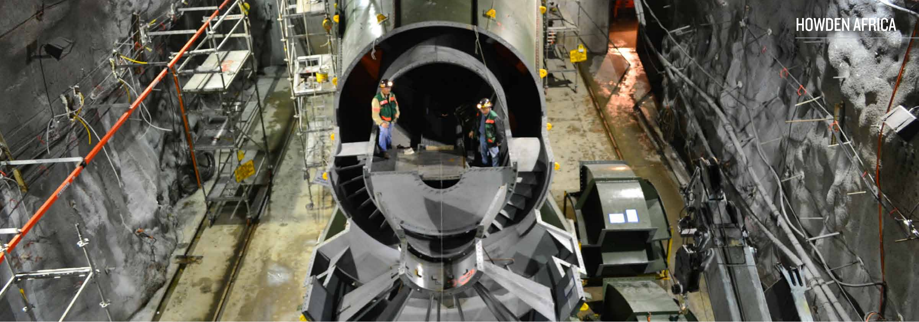
Underground booster fan
