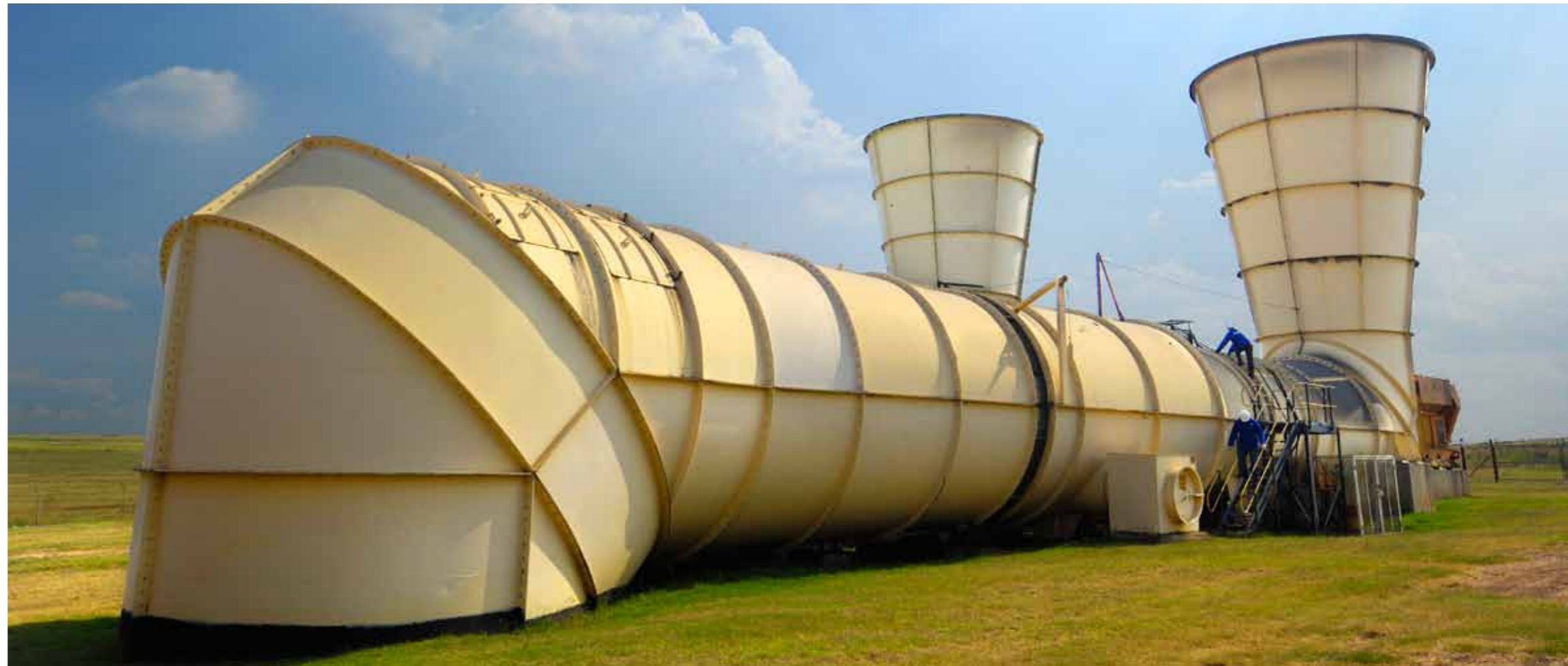
Howden main surface fan
