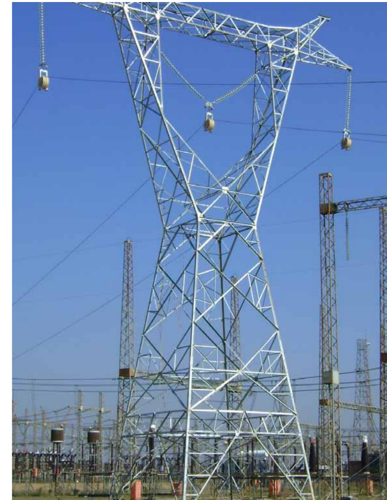
Grootvlei 400kV overhead line
